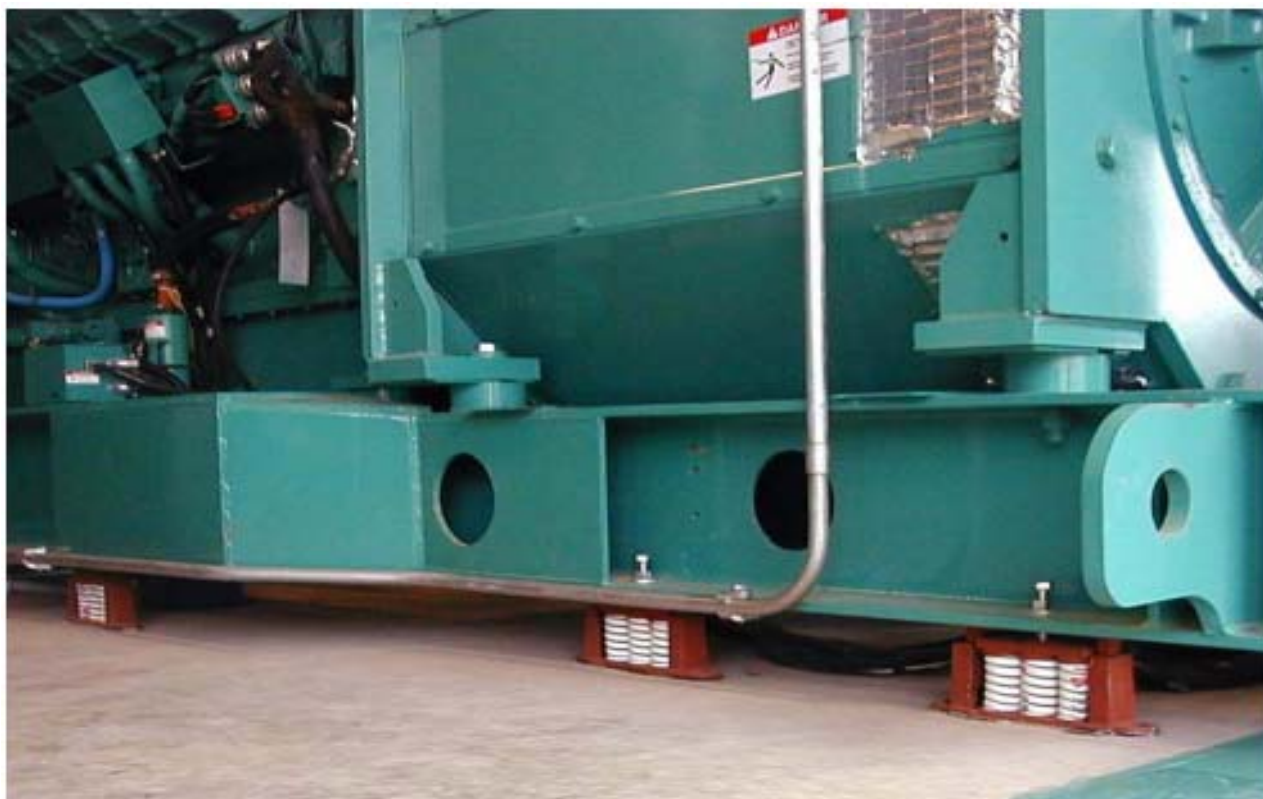
Рис.6–4. Генераторная установка, смонтированная на пружинных виброизоляторах.
