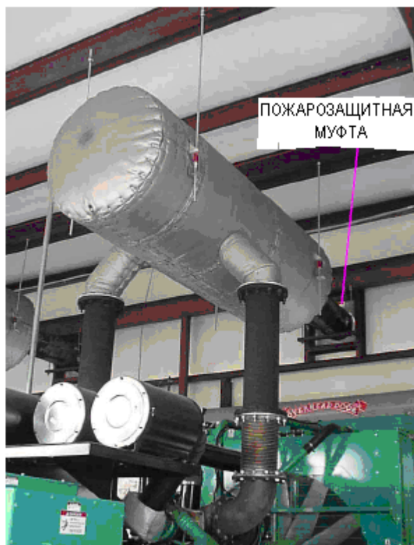
Рис.6–7: Детали системы выпуска генераторной установки: глушитель с двумя боковыми впускными каналами, гибкие трубные соединения, пожарозащитная проходная муфта и подвесные хомуты.
